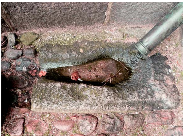
Nedløbsrør ved Slotsherrens hus på Frederiksborg slot. Selv denne sten under nedløbsrøret har spor af at være kløvet med lang rille!
