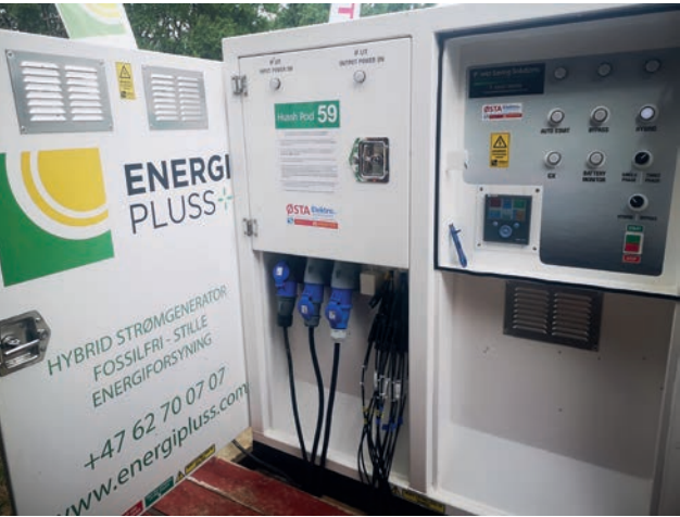
Herfra styres produksjon, lagring og bruk av solcellestrømmen. Foto: Jorunn Stubsjøen
